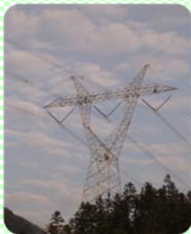
500kV线路铁塔
